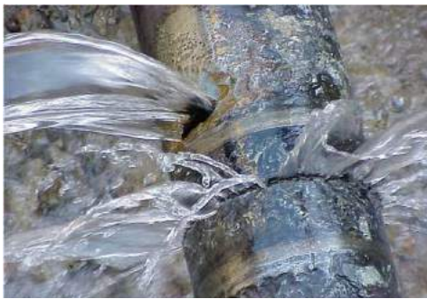
Рис. 4.30. Потери воды на магистральном водопроводе
